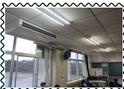
教室内エアコン設置状況
